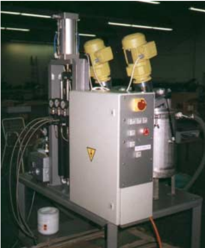
Panneau avec les appareils de commande
